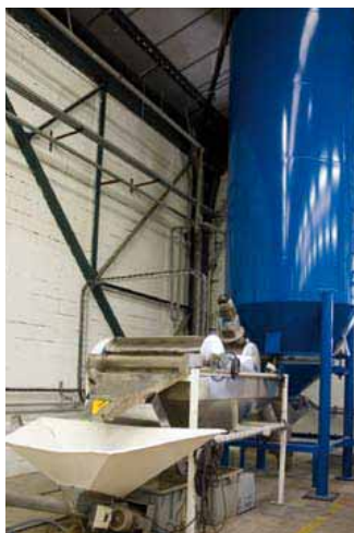
Lavage et séparation des pollutions à forte densité
